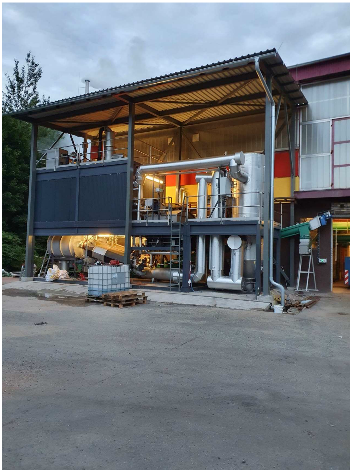
Obr. 6 – Celkový pohled na pyrolyzér PYREG P500 KSF
